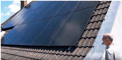
Pfarrgemeinde A.B. Korneuburg: Bau einer PV-Anlage mit Beteiligungsmodell über den unabhängigen Strom-Marktplatz eFriends.
